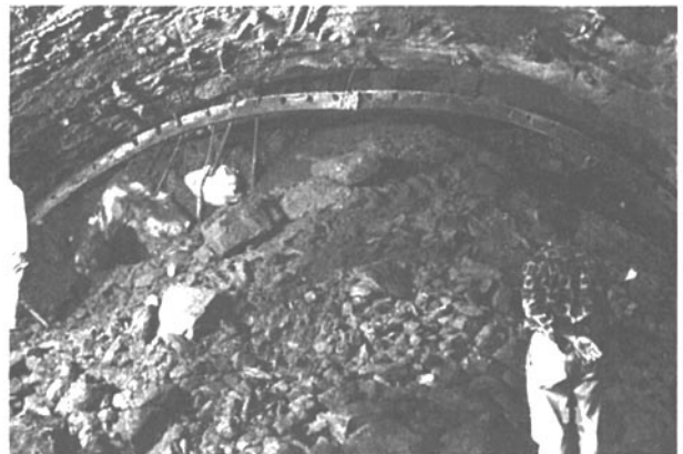
图 7 隧道掌子面塌方破坏实例
